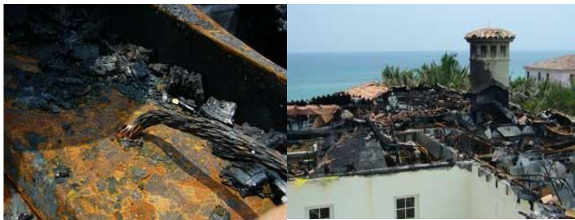
شکل 5-22. برخی خسارات ناشی از صاعقه
